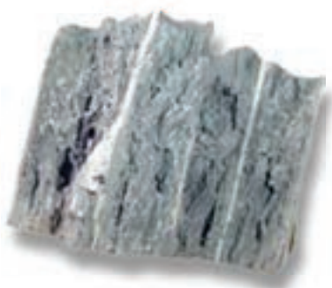
Fig.4 - Sono evidenti le deformazioni dei canali dovute a locali accumuli di calore generati da occlusioni recidive.
